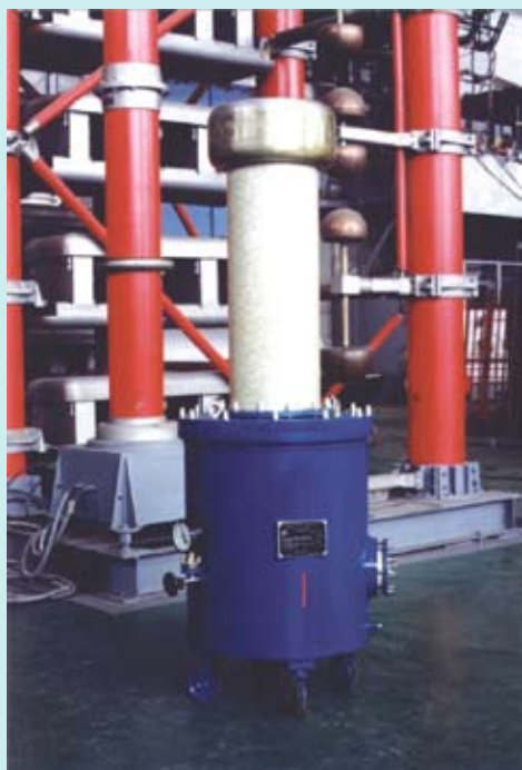
Рис. 4. Трансформатор напряжения ТНО-220-I
