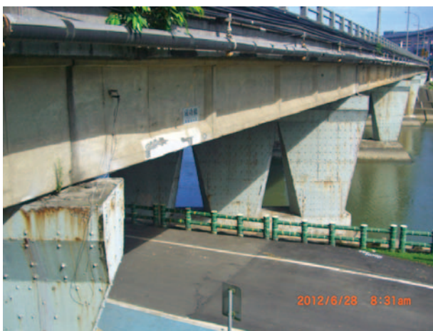
圖 45 成功橋—好醜的補強
