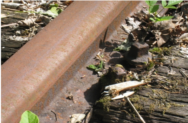
Figur 8. 32: Bemærk svelleskruerne kan ikke spændes til. Udvekslingsprocent på 100
