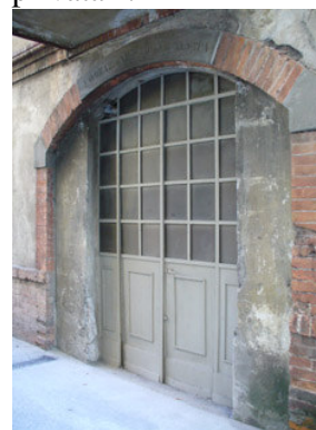
Una delle porte d'ingresso laterali del corpo di fabbrica che ospitava la sala dei cascami. Sopra il portale è ancora visibile la scritta: 'Lavorazione fiocco canapa'.
