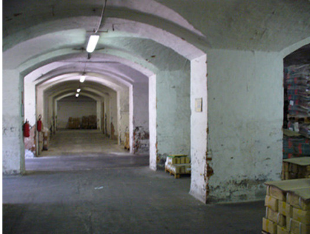
A destra i magazzini al piano terra Sotto a destra il locale in cui è alloggiato il motore ancora oggi usato del montacarichi A sinistra una puleggia a cui era ancorata una cinghia di trasmissione, meccanismo non più in uso
