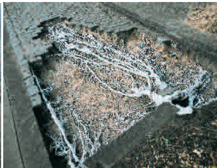
Oftmals wird erst nach Entfernen des Belags deutlich, welche Wurzelmassen sich unter Belägen verbergen und welche
