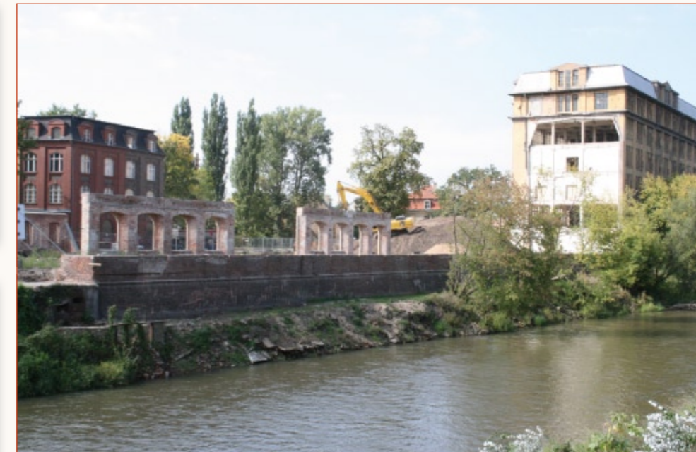
NACH DEM WEITGEHENDEN ABRUCH DER INDUSTRIEBAUTEN ÄNDERT SICH CHARAKTER UND FLAIR DES AREALS »GUBENER WOLLE« © EBP
