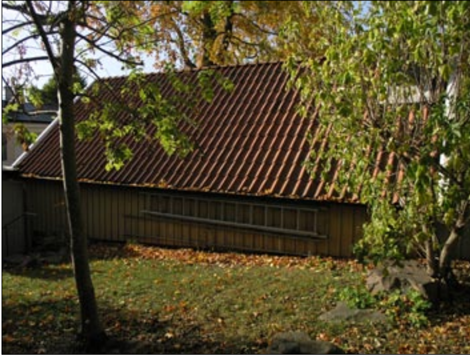
Sekundärt bostadsbus på fastigheten Robertshill, Drottningholm 1:22, utgör en del av den angränsande fastighetens omgärning. Bildnummer: lp20051194
