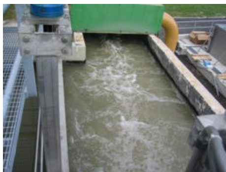
Foto 20: Vasca in ingresso all'impianto di depurazione di Peschiera del Garda
