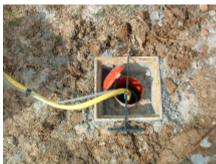
Foto 18: Piezometro utilizzato per il prelievo di campioni di acqua sotterranea
