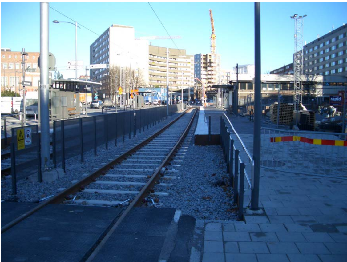
Foto 11: Eksempel på station med sideperroner som vist i fig 6.1. Bällsta bro station på forlængelsen til Solna station af Tvärbanan i Stockholm november 2012. Strækningen er her sidelagt i sydsiden af Landsvägen. Ibrugtages til Solna Centrum sommeren 2013.
