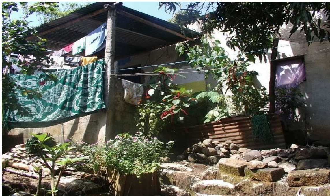
Imagen 5 Municipio de San Juan Bautista, Departamento de Suchitepéquez Riesgo de Deslaves y Derrumbes en Hogares Ubicados en Cantón El Plan Año: 2010
