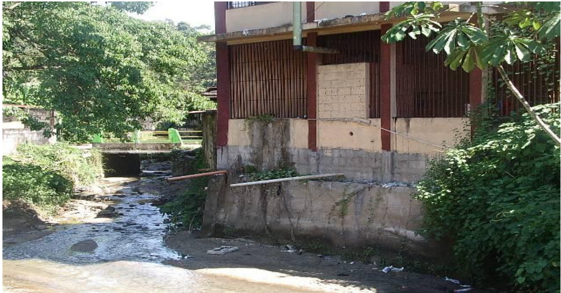
Imagen 6 Municipio de San Juan Bautista, Departamento de Suchitepéquez Falta de Mantenimiento de Drenajes Ubicados en Barrio San Luisito Año: 2010
