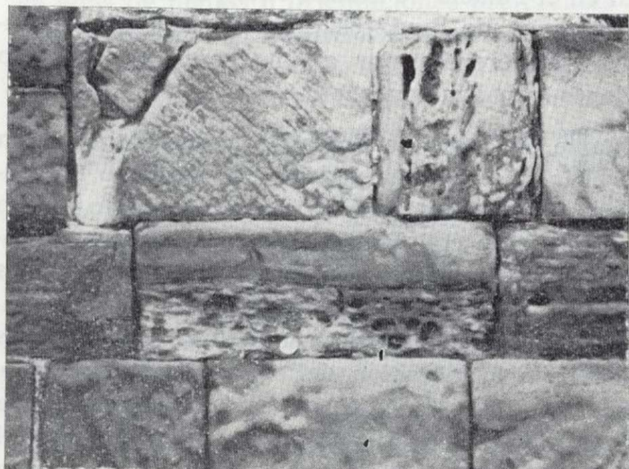
Figura 12.—Acanaladuras, fenómenos de abrasión y alveolos implantados en algunos de los sillares de la arenisca de la Iglesia de los Franciscanos. Obsérvese que la implantación de los alveolos está relacionada con la posición de los bloques y de sus planos de estratificación.
