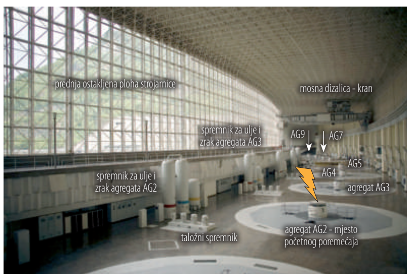
Ilustracija 3 Pogled na mjesto početnog poremećaja u strojarnici (prije havarije)
