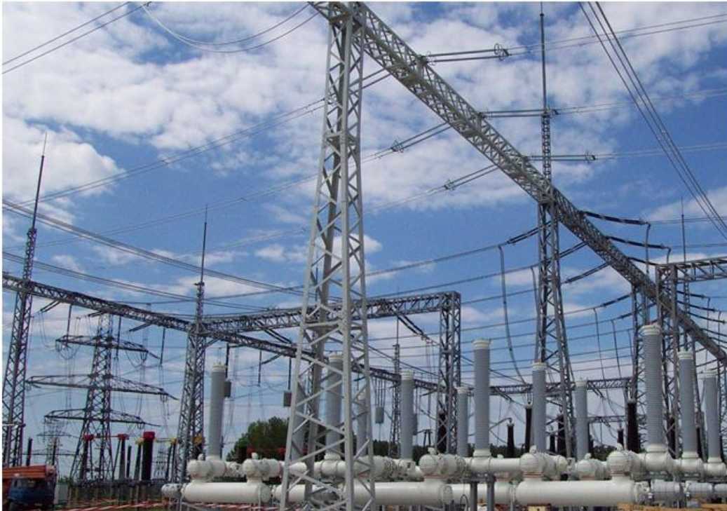
1.1-5. ábra: A 400 kV-os alállomás
