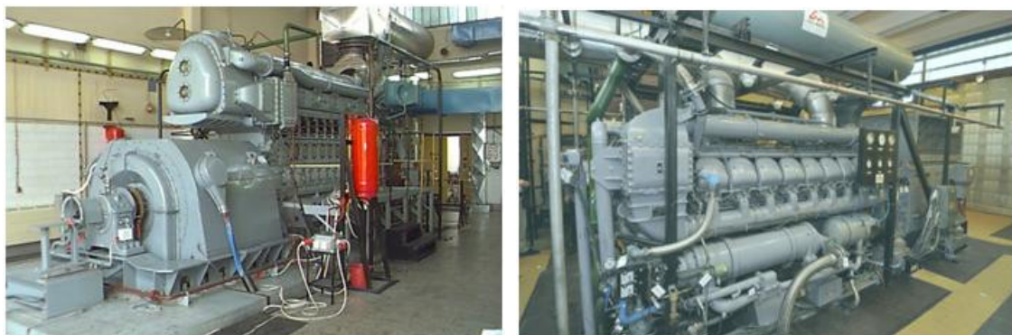
1.1-7. ábra: Az I. és II. kiépítés dízelgenerátorai
