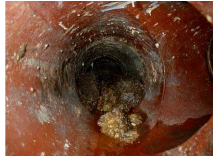
Ucpaná kanalizace (foto: Herčík & Kříž)
