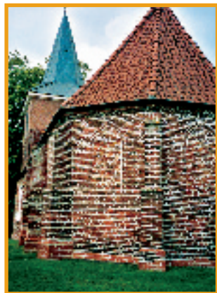
Der Chorraum hatte einst drei Fenster. Sie sind heute, gut erkennbar, zugemauert.
