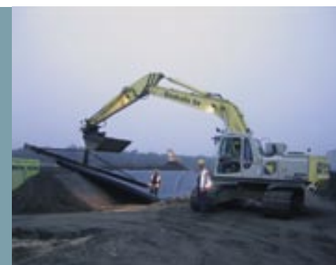
Oktober 2004: Omdat een gedeelte van de nieuwe autosnelweg in een grondwaterbeschermingsgebied ligt, wordt een speciale folielaag aangebracht.
