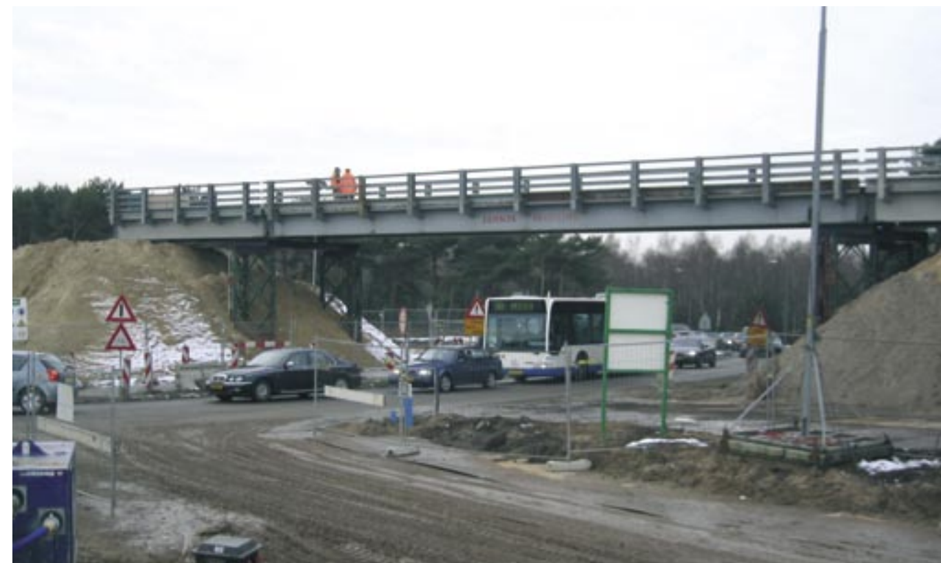
Januari 2004: De tijdelijke werkbrug is geplaatst en wordt medio februari in gebruik genomen. De zandwagens steken de Deken van Roestellaan over via deze werkbrug zodat het verkeer op de weg geen hinder ondervindt van het zandvervoer.
