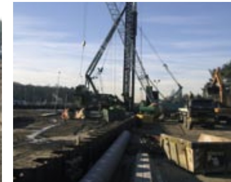
December 2003: De 34 meter hoge hei-installatie bij Maliskamp, waarmee de vibro combinatiepalen zijn geheid.
