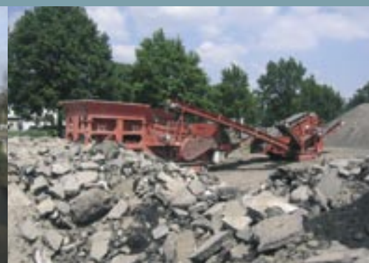
Mei 2004: De puinbreker breekt het oude wegdek tot fijn granulaat. Dit wordt hergebruikt als fundering in de nieuwe rijksweg. Ook betonpuin wordt gebroken en dient als fundering voor overige aan te leggen wegen.
