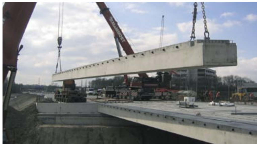
Februari 2004: De liggers voor het viaduct Stenenkamer worden vanaf een vrachtauto aan 2 grote kranen bevestigd en op de landhoofden getakeld.
