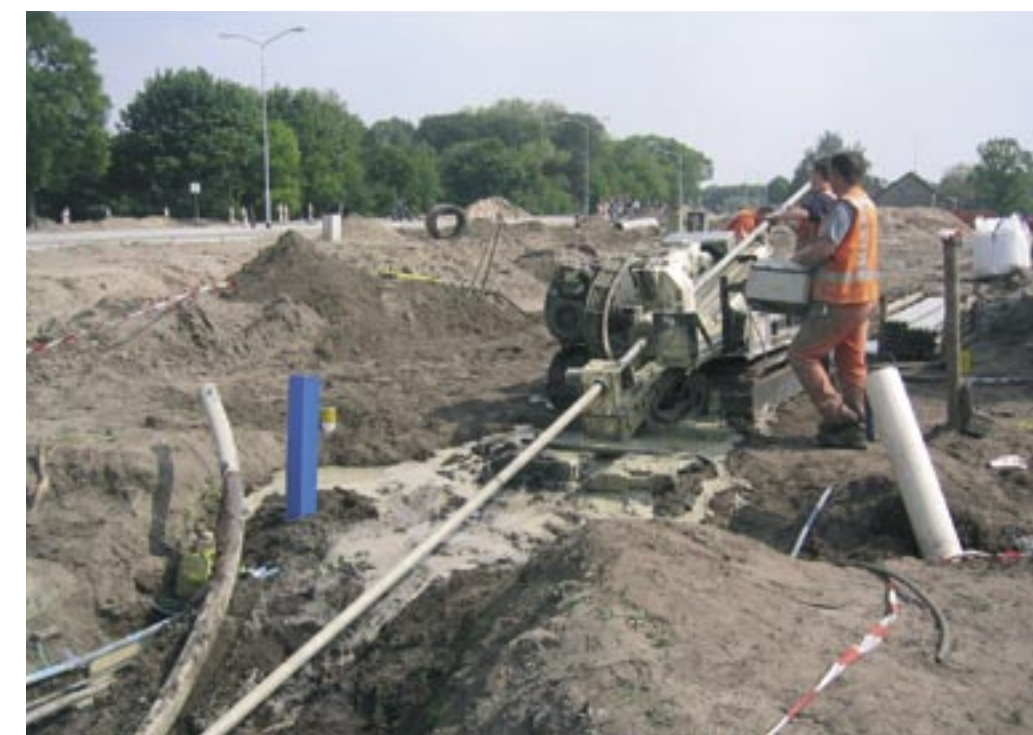
Mei 2004: Voor de aanleg van de A59 moeten de nodige kabels en leidingen verlegd worden. Sommige kabels worden door middel van boringen onder de weg door aangebracht.
