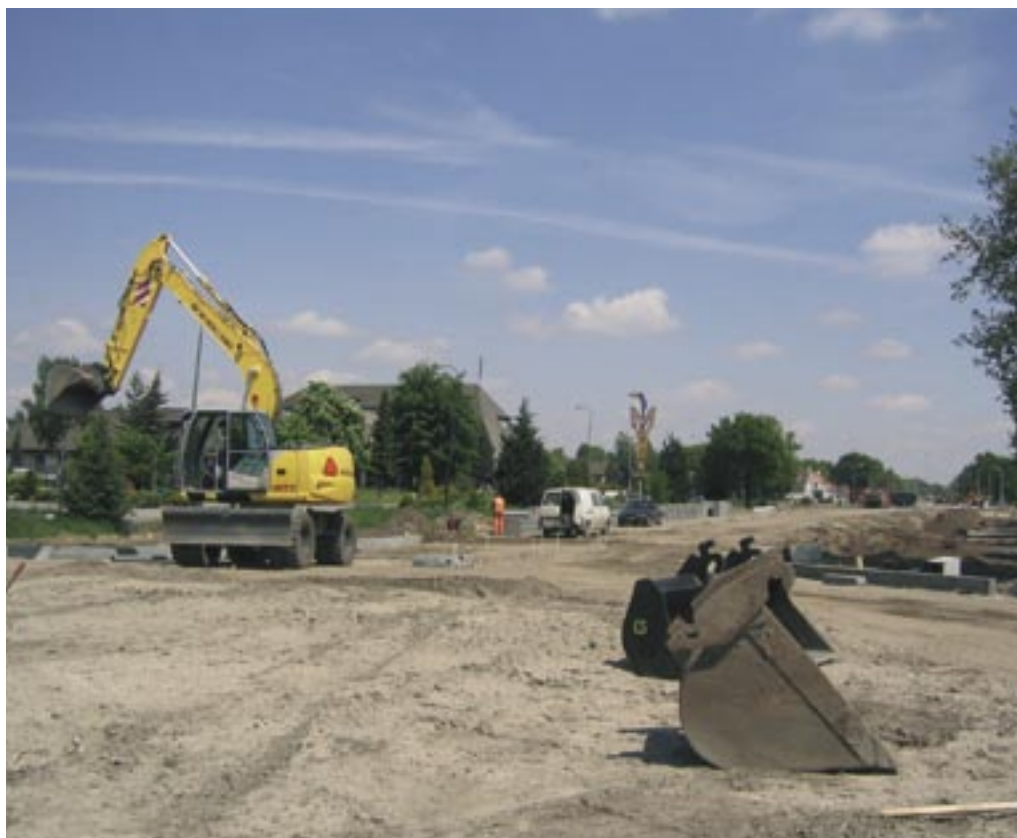
Mei 2005: Aanleg van de nieuwe rotonde bij de noordelijke aansluiting op de nieuwe rijksweg bij Nuland.
