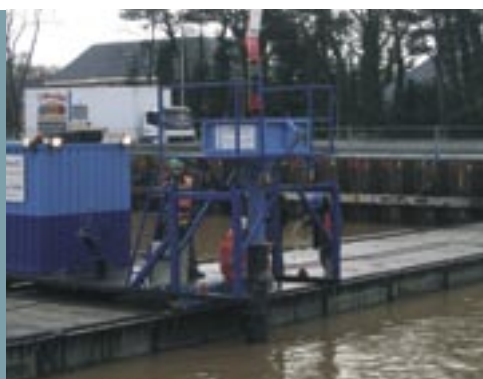
April 2004: Het onderwaterbeton bij Maliskamp wordt door middel van een pomp vanaf de wal via het ponton op de bodem van de bouwkuip gepompt. Als het onderwaterbeton is uitgehard, kan de bouwkuip worden leeggepompt en de werkloer worden aangebracht.
