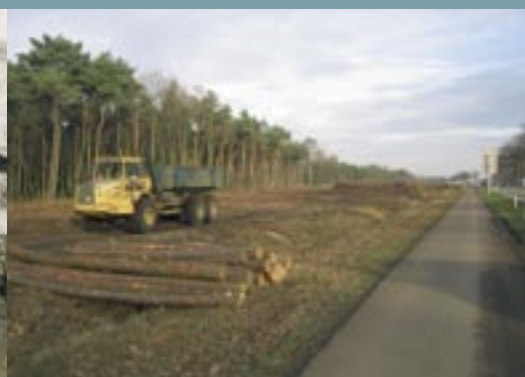
November 2003: Functievrijmaken van het terrein ten noorden van de rijksweg tussen de Vliertwijksestraat en Nuland.
