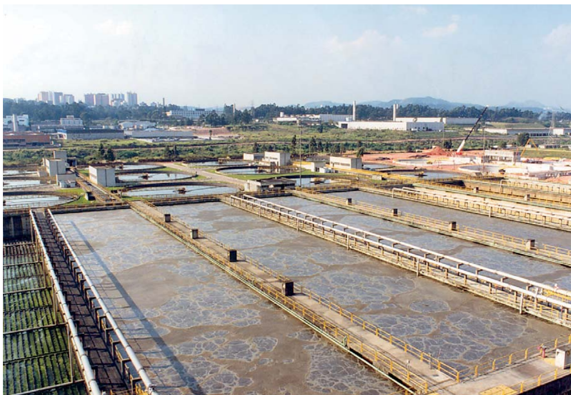
Figura 3.3.2 - Estação de Tratamento de Esgoto. Crédito: Acervo/SMA
