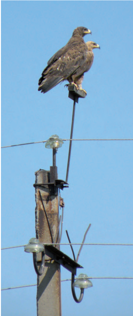
Пара степных орлов (Aquila nipalensis) на частично изолированной присаде, установленной на птицеопасной ЛЭП 10 кВ. Этот вид один из самых страдающих от гибели на ЛЭП. Фото И. Смелянского.
