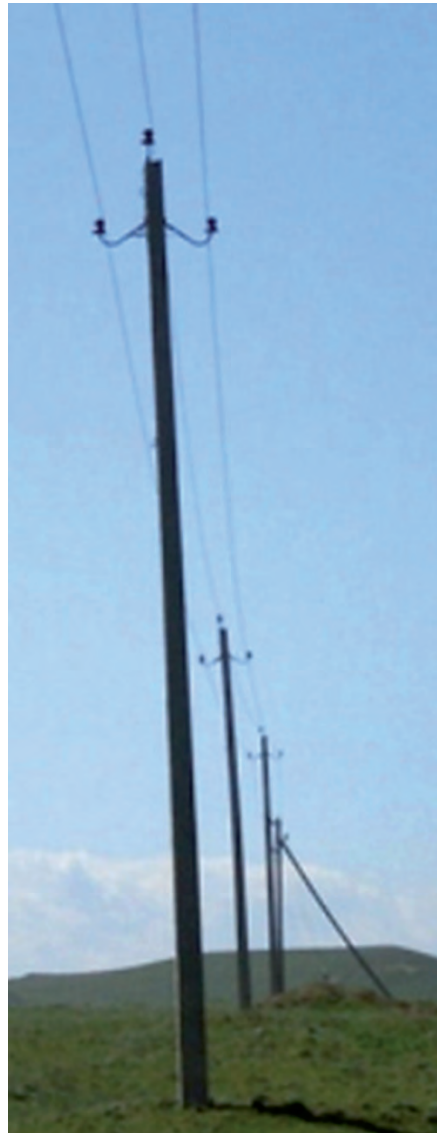
Фото 3. ЛЭП в Дербентском районе с железобетонными опорами.
