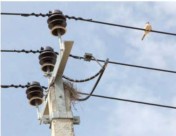
Опора ВЛ 10 кВ катодной защиты трубопровода «Тенгиз – Новороссийск», принадлежащей компании «Каспийский трубопроводный консорциум», в низовьях р. Эмба – оборудована самонесущим изолированным проводом (СИП-3) на штыревых изоляторах. Данная конструкция практически исключает возможность гибели птиц от поражения электрическим током и является оптимальной. Фото М. Пестова.
