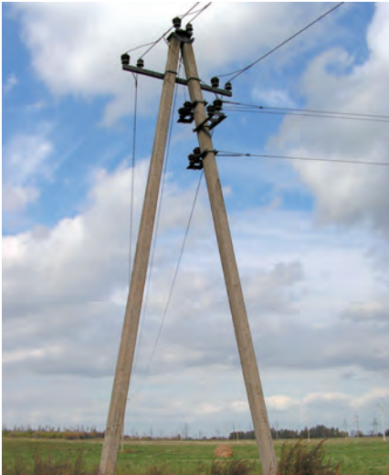
Фото 5. Угловые либо опоры с отпайкой ЛЭП 10 кВ со штыревыми изоляторами представляют наибольшую опасность для птиц.
