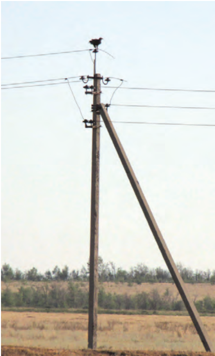
Хищные птицы, присаживающиеся на незащищённые опоры ЛЭП 10 кВ, выживают достаточно редко. Фото С. Бакки.
