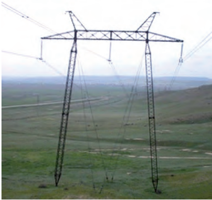
Фото 2. Высоковольтные ЛЭП в Дербентском районе напряжением 500 кВ.
