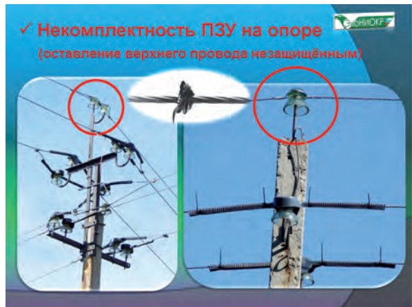
Рис. 13. Некомплектность ПЗУ на опоре.
