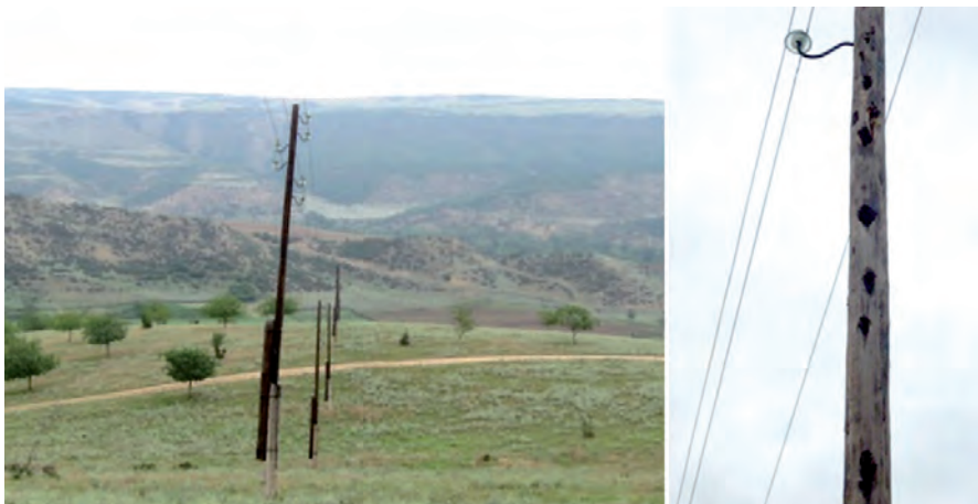
Фото 1. ЛЭП в Табасаранском районе с деревянными опорами (справа – опора ЛЭП, повреждённая дуплогнёздиками).
