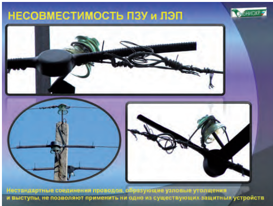
Рис. 14. Невозможность установки ПЗУ на опоре.
