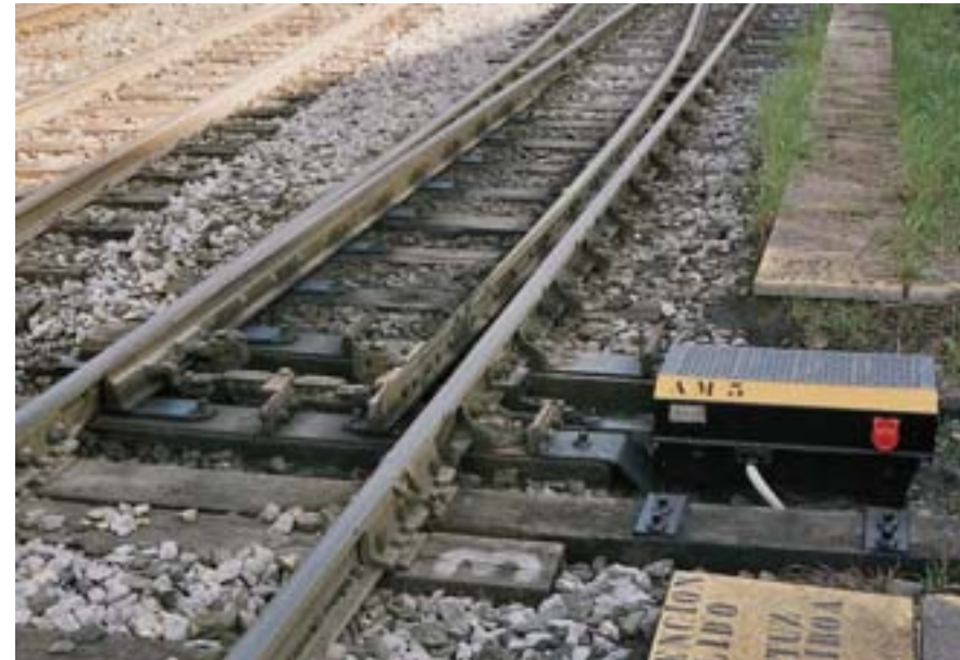
ORRATZ ALDAKETA MOTORIZATUA GERNIKAKO GELTOKIAN. ARGAZKIA, JUANJO OLAIZOLA. CAMBIO DE AGUJAS MOTORIZADO DE LA ESTACIÓN DE GUERNICA. FOTO, JUANJO OLAIZOLA.
