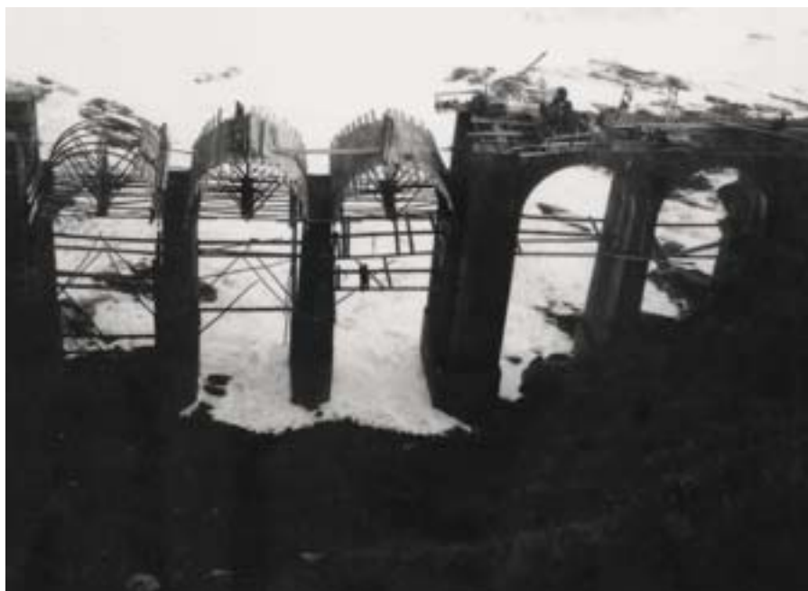
ITSASOKO URAREN GAINEAN LAMIARANGO BIDEZUBIA ERAIKITZEAK ZAILTASUN HANDIAK ERAGIN ZITUEN. EUSKO TRENEAN ARTXIBATEGIA. LA CONSTRUCCIÓN DEL VIADUCTO DE LAMIARAN SOBRE LAS AGUAS DEL MAR OFRECIÓ SERIAS DIFICULTADES. ARCHIVO EUSKO TREN.
