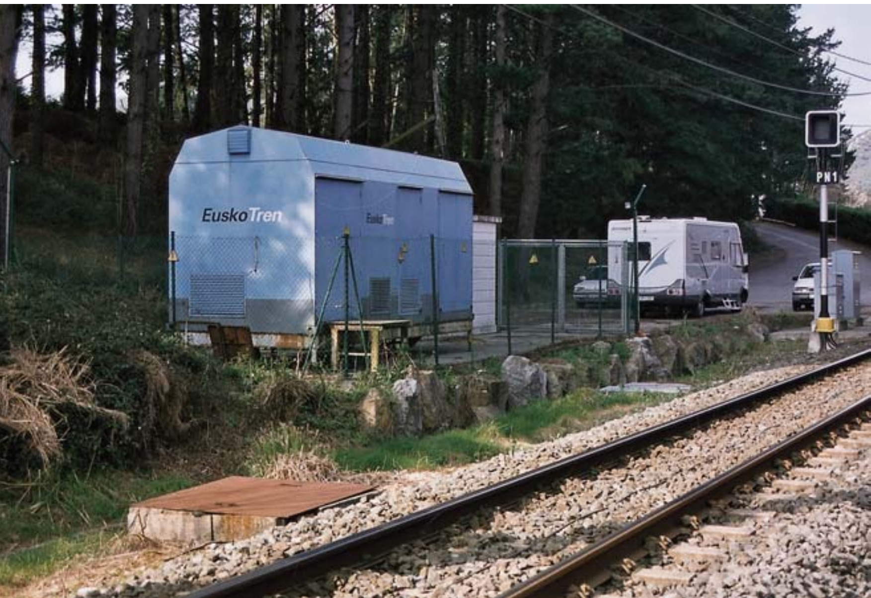
MURUETAKO AZPI-ESTAZIO MUGIKORRA. ARGAZKIA, JUANJO OLAIZOLA. SUBESTACIÓN MÓVIL DE MURUETA. FOTO, JUANJO OLAIZOLA.
