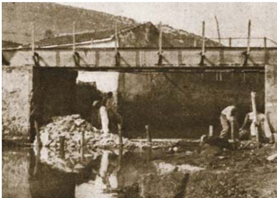
GERRA ZIBILAREN ONDOREN, EXPLOTACIÓÑ DE FERROCARRILES POR EL ESTADO IZENEKOAK SAN KRISTOBALGO ZUBIA ALDATZEA ERABAKI ZUEN. TRENAREN EUSKAL MUSEOAREN ARTXIBATEGIA. TRAS LA GUERRA CIVIL LA EXPLOTACIÓN DE FERROCARRILES POR EL ESTADO PROCEDÍO A SUSTITUIR EL PUENTE DE SAN CRISTOBAL. ARCHIVO DEL MUSEO VASCO DEL FERROCARRIL.
