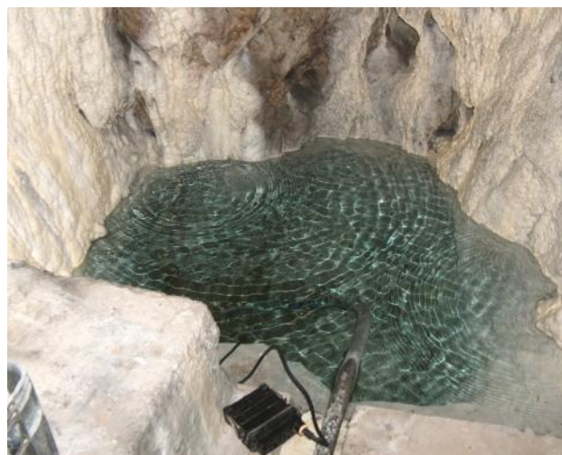
F.8.9.4 Bazin de apă cu depuneri de carbonat de calciu, casa Clitnovici.
