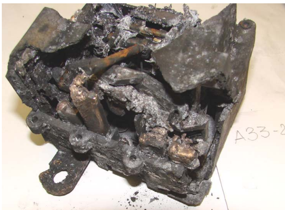
Рис. 17. Состояние автомата защиты сети АЗЗ-200К
