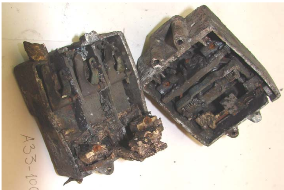
Рисунок 18. Состояние автомата защиты сети А33-100
