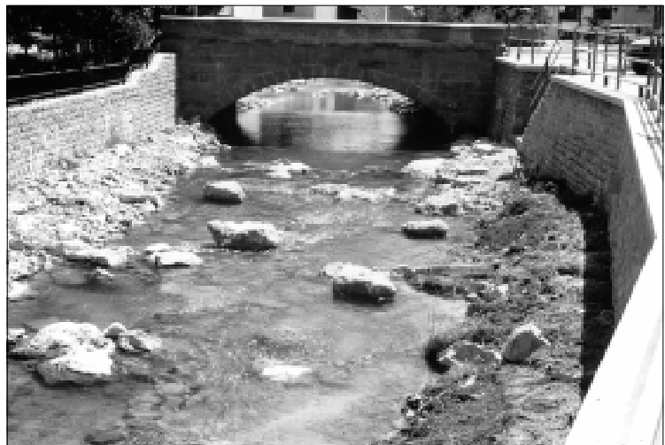
Foto 31-2: Die Leinleiter und die „Zolleisenbrücke“ nach der Sanierung. Die Ufermauern wurden befestigt und Steine im Bachbett verlegt. (Foto: Wasserwirtschaftsamt Bamberg)
