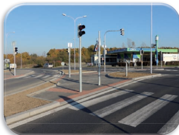
Obnovené SSZ 0.393 Mírového hnutí – K Horkám
