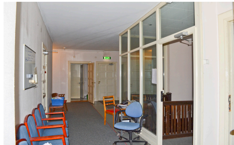
För att tillskapa en brandcell har man byggt upp ett väggparti med brandglas mot hallen i övre plan. På detta plan är golven belagda med sekundär linoleum och lamellparketter. Den trånga planslösningen med många små rum är däremot till stor del ursprunglig, liksom snickerierna såsom dörrblad, dörrfoder, fotlister m.m. Till vänster den dörr som leder in till huvudsovrummet.
