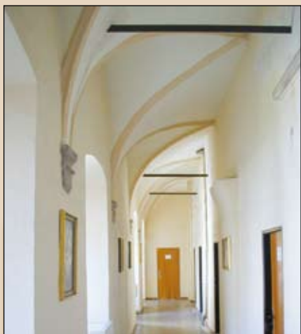
Zbytky klenby zrušeného velkého renesančního sálu
