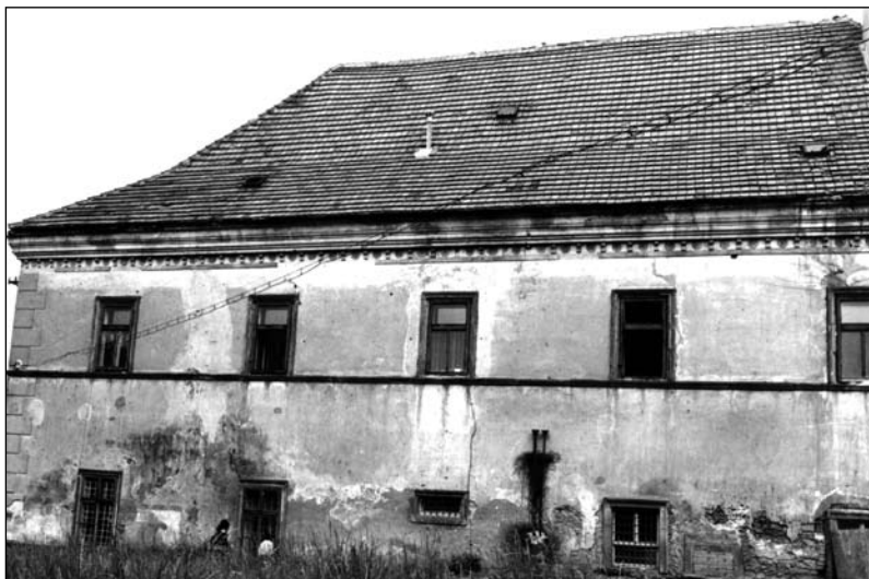
Stav omítek v roce 1976
