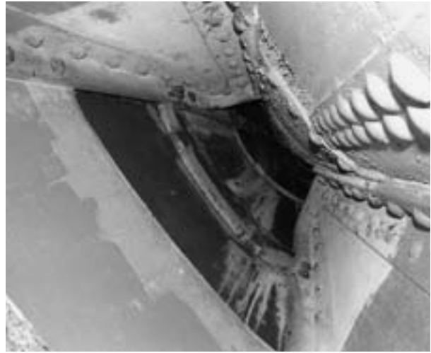
5 Blick nach oben von der mittleren Plattform aus zwischen Eisenröhre, Spantenträger und Innerem der Kupferhaut der Figur. 2006.
