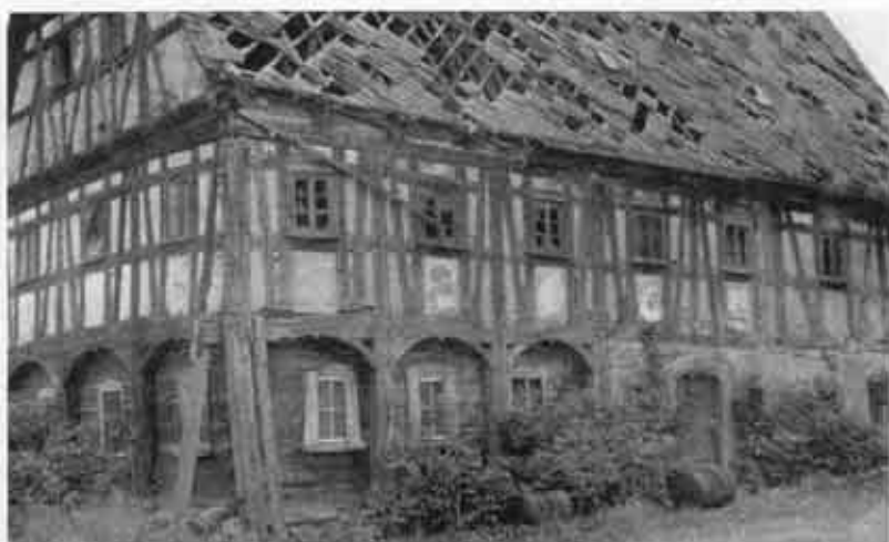
19 Ergebnis mangelnder Pflege: Hauszerstörung. Die Holzkonstruktionen dieses Hauses, das einerseits Langständer, andererseits der Geschossbauweise zugehörige Elemente enthält, sind außerordentlich bedeutungsvoll — Oberseifersdorf, Kreis Zittau, Nr. 99.
