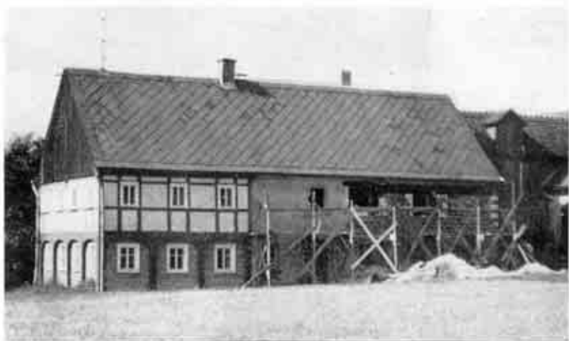
25 Schwerwiegende bauliche Veränderung. Die zur Zeit der Aufnahme begonnene Umgestaltung entwertet die bodenständige Bauweise völlig – Hörnitz, Kreis Zittau.
