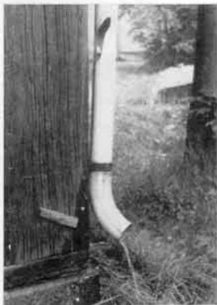
21 Fallrohrschäden und Rinnenschäden begünstigen Durchfeuchtungen. Löcher dieser Größe können noch jederzeit, auch vom Laien, geschlossen werden.
