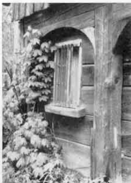
20 Bewuchs am Haus erschwert die Austrocknung und begünstigt Schädlingsbefall.
