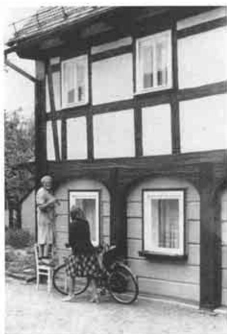
31 Eigenleistung bei der Holzpflege. Natürlich ist für weiter oben auszuführende Arbeiten ein Gerüst (notfalls Leiter) erforderlich. Schade, daß die Fenster im Erdgeschoß nicht wenigstens Mittelsprossen haben. So wirken sie etwas unproportioniert zum Haus.
