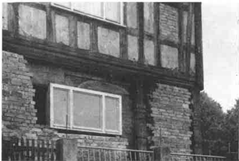
23 Mauerwerk ersetzt Holzbauteile. Die gewählten Fenster sind völlig falsch für dörfliche Hausbauformen — Ebersbach, Kreis Löbau, Spreedorf.
