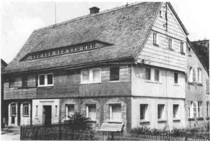
22 Mauerwerk ersetzt, Putz überdeckt Holzbauteile. Landschaftstypische Bauformen wurden aufgegeben, Fenster willkürlich in der Ansicht verteilt. Gut ist, daß man nicht breitformatige Fenster einbaute und statt dessen Koppelfenster wählte. Auch der alte Anbau ist recht willkürlich „angelebt“ — Seiffhennersdorf, Kreis Zittau, An der Aue 4.
