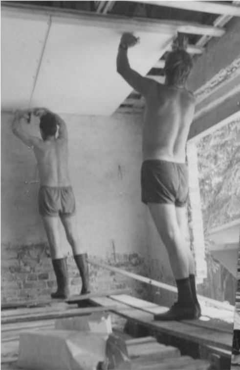
Deckendämmung aus Polystyrol-Schaumstoff – ein Novum im Jahre 1971 – zumindest im privaten Wohnungsbau der DDR.
