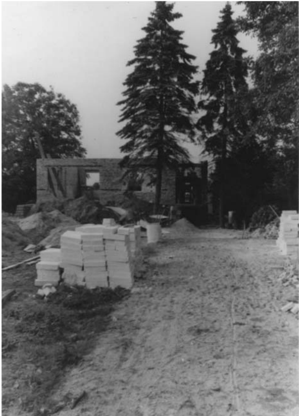
Pfingstsonntag 1971 – die Ringwände stehen. Nun sehen auch die zweifelnden Nachbarn, dass es weiter geht. Die noch fehlenden Mauerziegel werden durch Porenanhydrit ersetzt (heller Stapel im Vordergrund).
