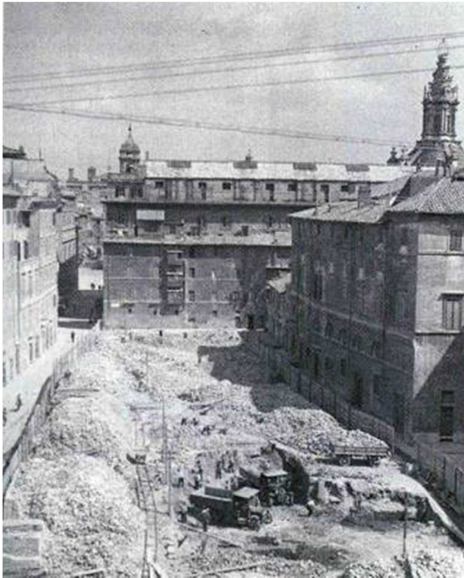
Veduta delle demolizioni dell'isolato compreso tra via dei Sediari e vicolo del Melone
