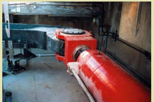
Aansluiting cilinder aan draaiarm sluisdeur.
