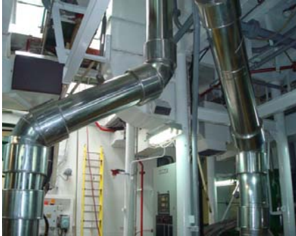
Sistema de gases de escape
