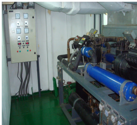
Planta de acondicionamiento de aire.
