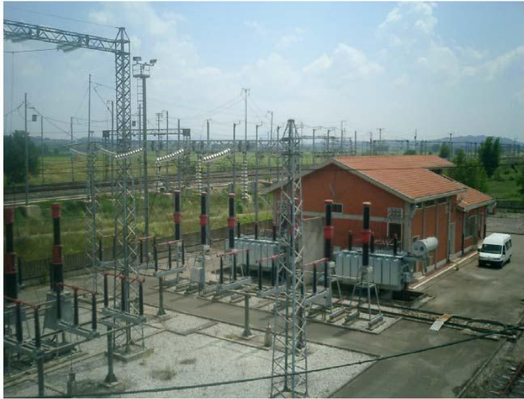
Figura 46: una moderna sottostazione elettrica ferroviaria
