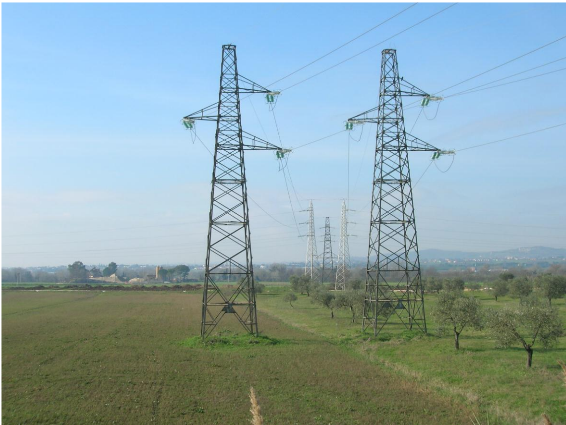
Figura 40: le linee primarie a 130.000 Volt che alimentano la SSE di Fara Sabina
