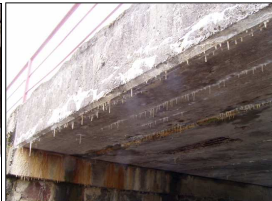
Hüdroisolatsioon lekib. Sillaplaadi kahjustused.
