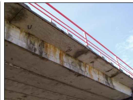
Hüdroisolatsiooni lokaalsed lekked.
