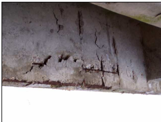
Silla taladel armatuur paljandunud.
