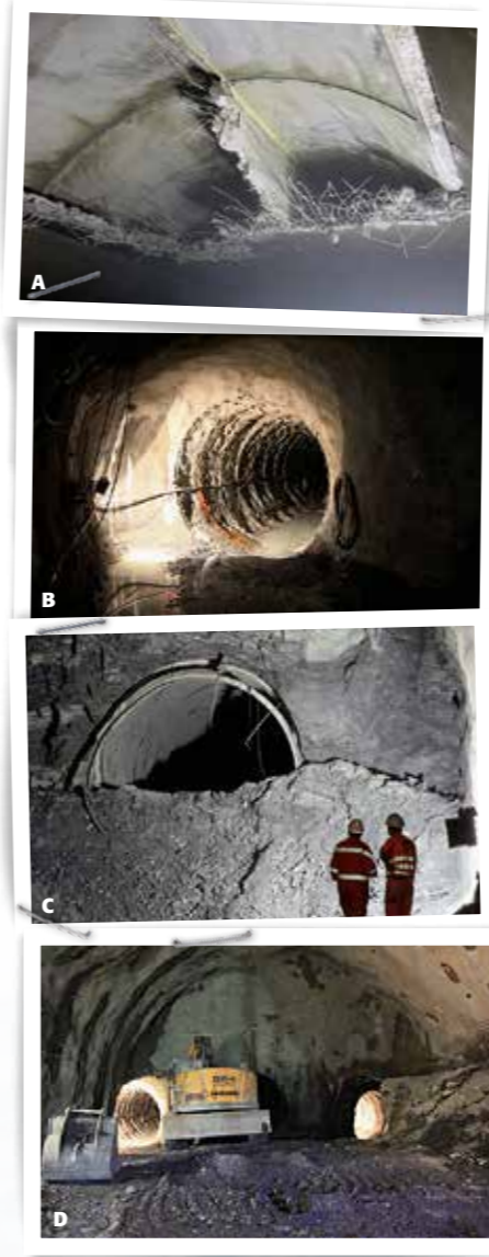
A Rückbauarbeiten im Vispertaltunnel. B + C Tunnelsicherung beim Ausbruch durch die Störzone. D Links und rechts die seitlichen Widerlagerstollen, welche später mit Beton verfüllt werden.
