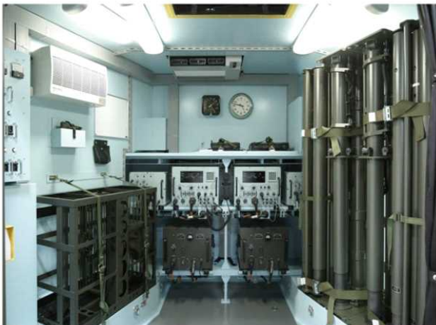
図1 幹線用無線搬送装置
