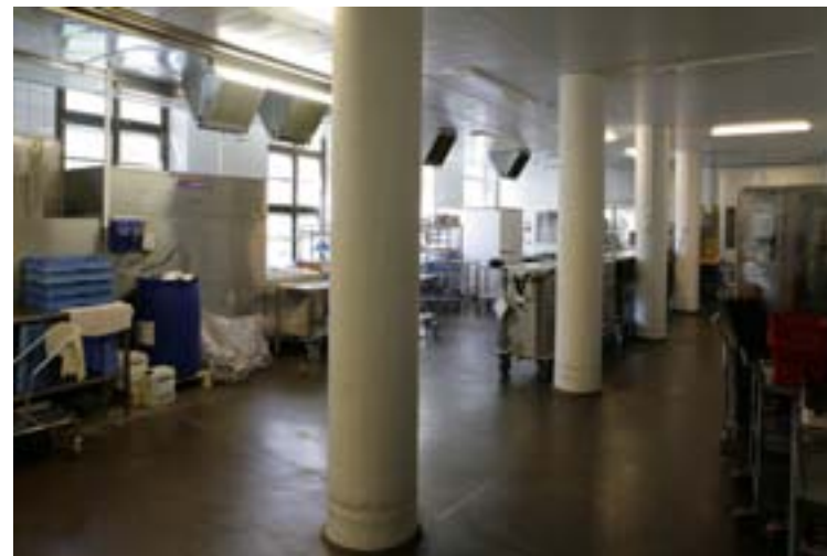
Sienipilareiden yläosa on jäänyt alaslasketun katon yläpulelle. Sali on palautettavissa. Päärakennus 2. krs 2009. Kuva Sami Heikinheimo, Ark-byroo.
