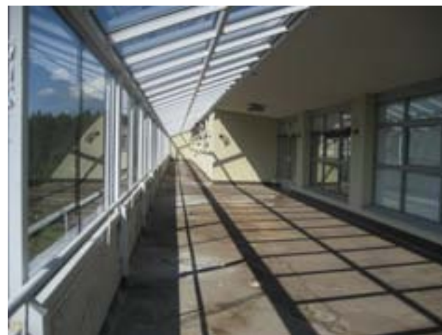
◀◀ Naisosaston potilaita hallimakuulla 1960-luvun puolivälissä. Betonilippa on vielä alkuperäisessä asussaan. Laatta oli verhottu lasittamattomilla keltaisilla uritetuilla klink- kereillä, jollaisia käytettiin myös muissa 1939 valmistuneissa rakennuksissa. SMK 80_1
