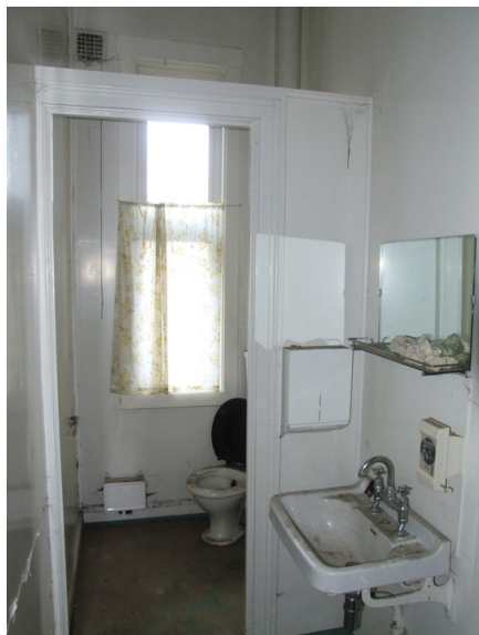
Eldre armaturer og innredning. Foto: Leif Anker, Forsvarsbygg.
