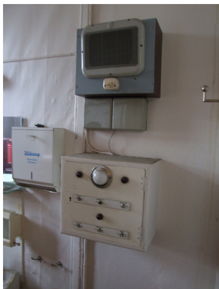
Alarmerhet vaktrom. Foto: Leif Anker, Forsvarsbygg.
