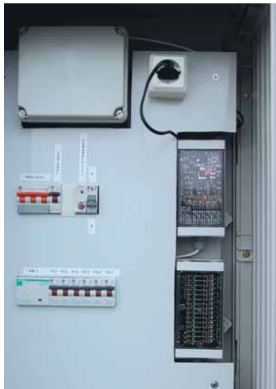
Joonis 2. Tänavavalgustuse juhtseade (kontroller) elektrikilbis
