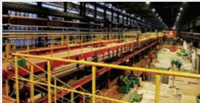
A KÉSZ Kft. végezte el – a BIS Rt.-vel konzorciumban – a dunaujvárosi hengermű technológiai-rekonstrukciós munkálatait
