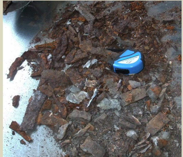
Pääosa sisäisistä tukirautoista oli murentunut täysin.
