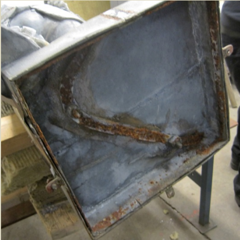
Vanha plintti alapuolelta.
