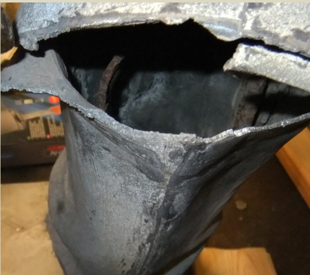
Jalan sisällä näkyy vielä ruostuneiden tukirautojen jäänteitä.
