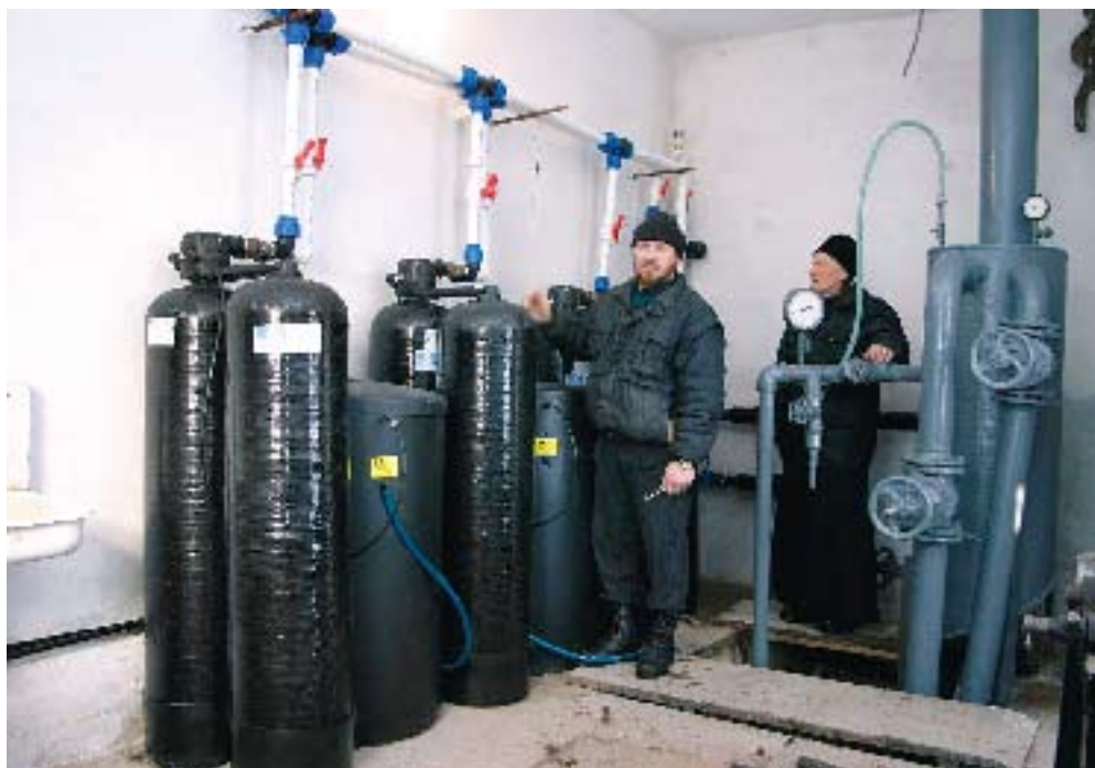
Очистка от железа воды из монастырской скважины.
