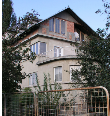
„Védett” bauhaus épület stílusromboló tető ráépítéssel
