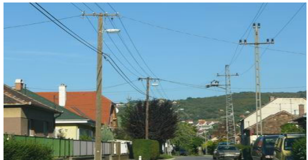
Bal oldalon kiefeszültségű, közvilágítási és hírközlési hálózatok közös oszlopsoron, jobb oldalt 20 kV-os távvezeték.
