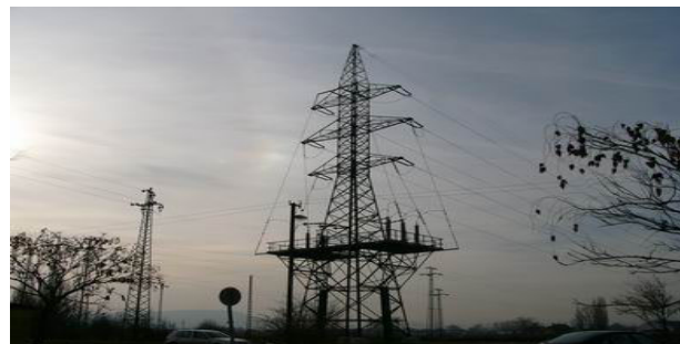
Vasút melletti 120 kV-os távvezeték tartóoszlop
