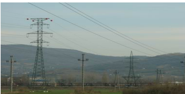
120 kV-os távvezeték jelzőgömbökkel
