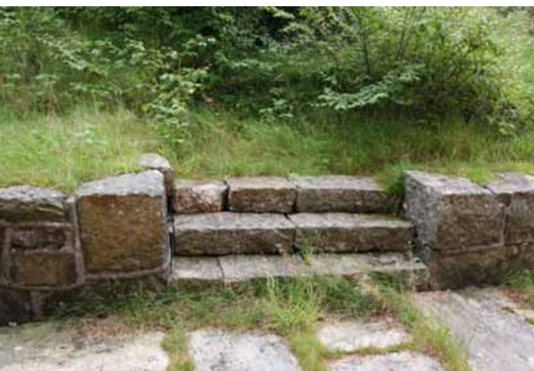
Trapp fra platting til sti. Vi ser også de karakteristiske murfugene her. Bilde: Byantikvaren.
