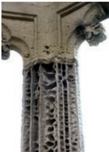
15. Alveolización muy acusada en una arenisca. Fachada norte del palacio de Sobrellano, Comillas (Cantabria), 2007.
