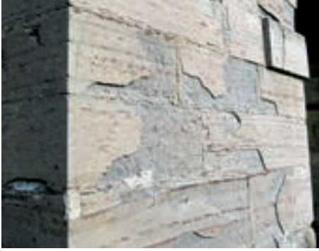
1.33. Desplacación en arenisca. Santuario de los Mártires de Valdecuana (Asturias), 2007. 1.33. Spalling of sandstone. Church sanctuary of Mártires de Valdecuana (Asturias). 2007.
