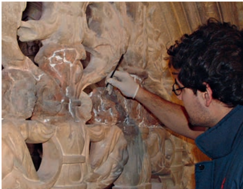
Figura 28. Sellado de fisuras con mortero de cal. Figure 28. Sealing cracks with lime-based mortar.
