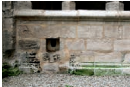
1.22. Corrosión en la dolomía micrítica de Laspra, asociada a un mingitorio. Claustro bajo de la catedral de Oviedo (Asturias), 2004.
