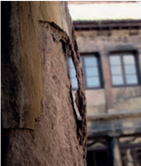
1.35. Desplacación perimetral en la caliza rojiza de La Granda. Claustro del monasterio de San Pelayo, Oviedo (Asturias), 2010. 1.35. Contour scaling on reddish limestone from La Granda. Cloister of San Pelayo Monastery, Oviedo (Asturias). 2010.
