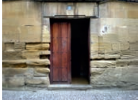
1.10. Vaciado de sillares en una arenisca arcillosa. Fachada en Santo Domingo de la Calzada (La Rioja), 2009.
