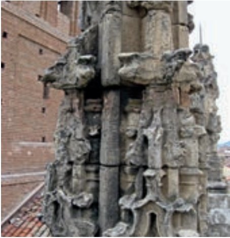
4.9. Cuarteado en una caliza margosa. Terraza en el convento de Santa Clara, Tordesillas (Valladolid), 2007. 4.9. Crazing in marly limestone. Terrace in the convent of StClaire, Tordesillas (Valladolid). 2007.
