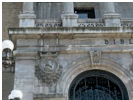
2.4. Ensuciamiento en un granito. Fachada de la Biblioteca Nacional (Madrid), 2010.
