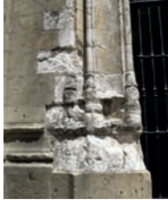
1.2. Erosión diferencial entre la caliza bioclástica de Piedramuelle y la dolomía micrítica de Laspra. Portada de la catedral de Oviedo (Asturias), 2010. 1.2. Differential erosion between the bioclastic limestone from Piedramuelle and the micritic dolomite from Laspra. Main entrance to Oviedo Cathedral (Asturias). 2010.
