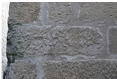
1.39. Disyunción de películas sobre una arenisca. Edificio en Sos del Rey Católico (Zaragoza), 2009.
