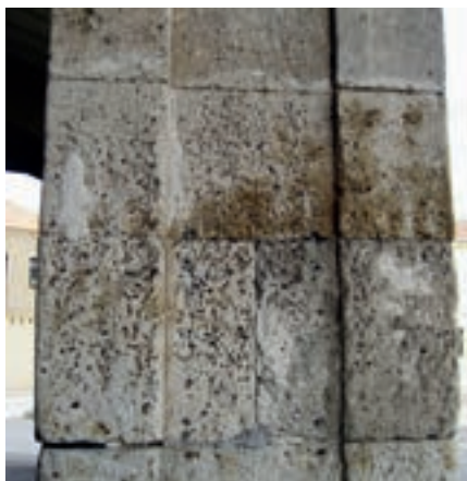
3.11. Moteado de origen antrópico en una arenisca. Pórtico de la iglesia de Santa Elena, Calzada de Valdunciel (Salamanca), 2009.
