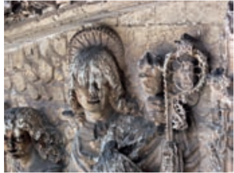
2.2 Depósito de excrementos sobre una figura labrada en la caliza de Hontoria. Fachada de la iglesia de San Pablo (Valladolid), 2007.
