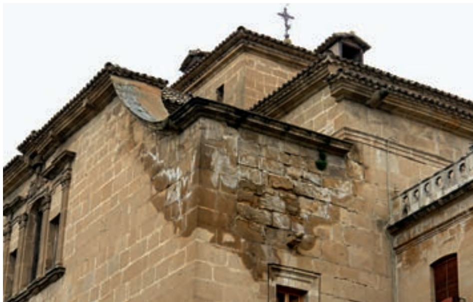
Figura 5. Mancha producida por el efecto de la humedad y las sales, iglesia de la Trinidad (Úbeda, Jaén).
