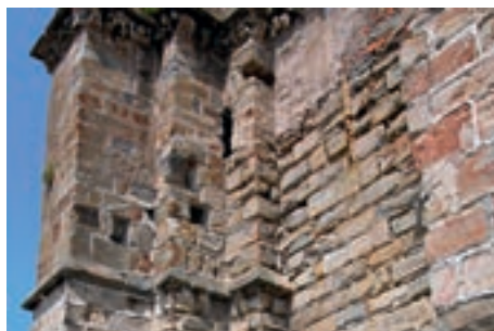
1.41. Pérdida de volumen en sillares de arenisca. Fachada de la iglesia de Santa María, Castro Urdiales (Cantabria), 2006.
