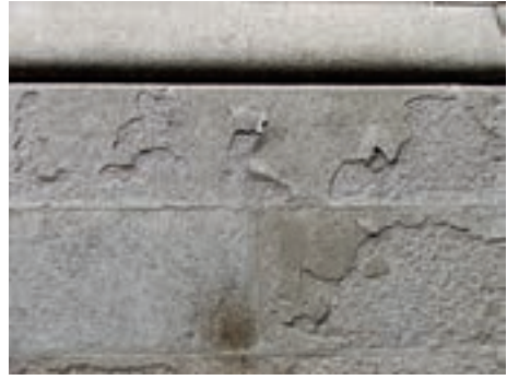
1.34. Microdesplacación en sillares de granito. Fachada de la Biblioteca Nacional (Madrid), 2004. 1.34. Microspalling on granite ashlars. Façade of the Biblioteca Nacional (National Library) (Madrid). 2004.
