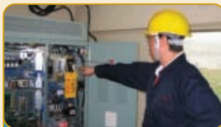
切斷電源及掛牌後，再使用指差呼稱。
