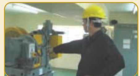
按機房曳引機座上的緊急停止掣前使用。
