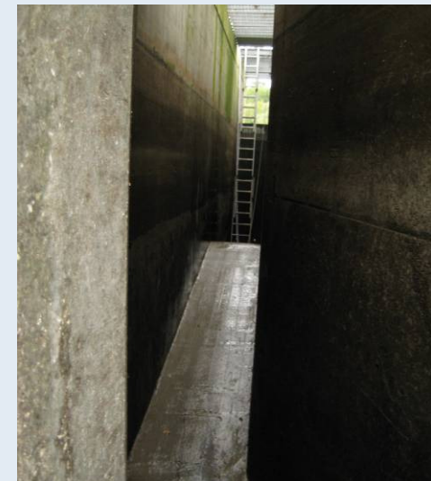
Überfallwehr im Bypass während der Bau-phase (im Hintergrund bauzeitl. Revisionsverschluss zum Unterwasser), Foto: A. Gluch
