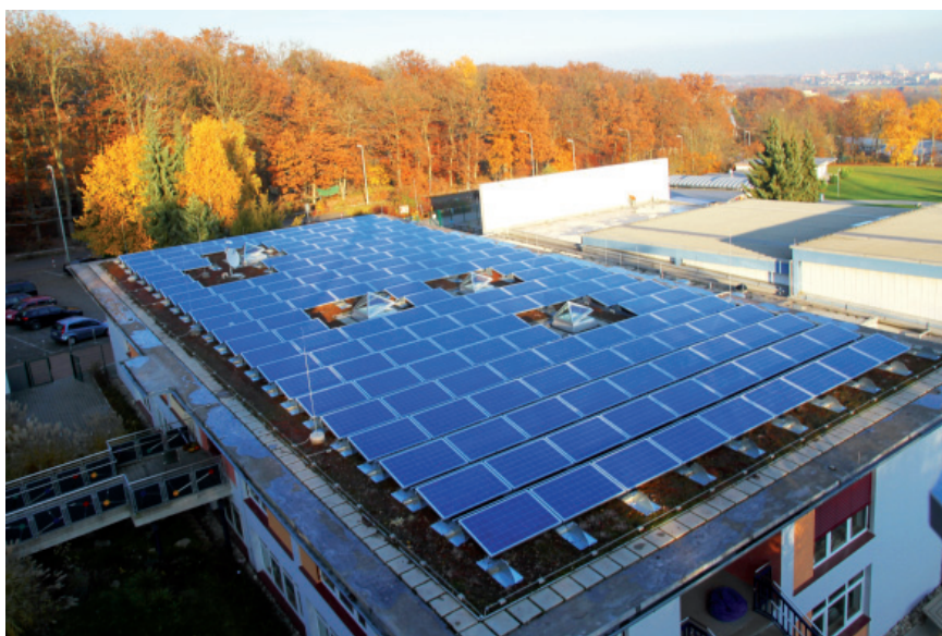
Bürgersolaranlage Schwimmbad Kelkheim
