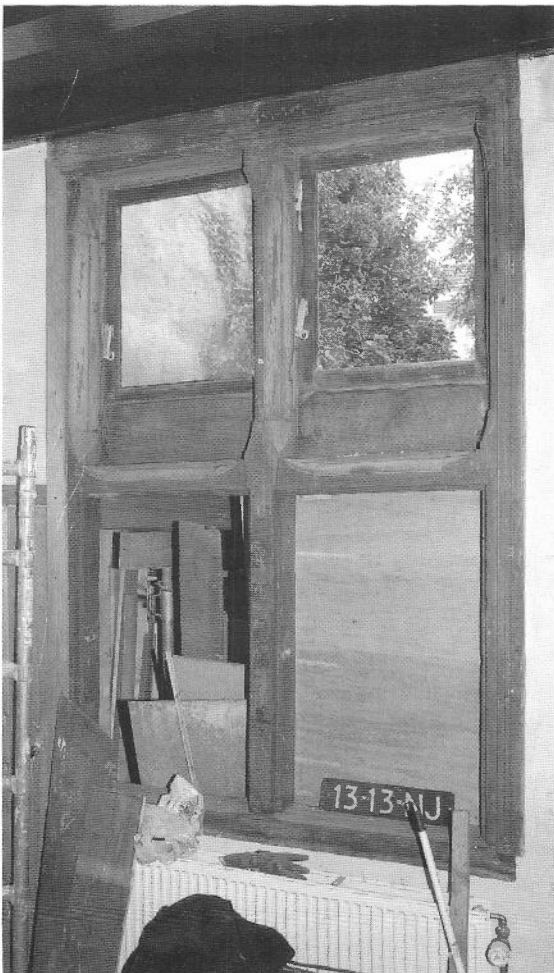
Origineel houten kruiskozijn in de achtergevel van Oosthaven 14. Het kozijn wordt binnenkort gerestaureerd.
