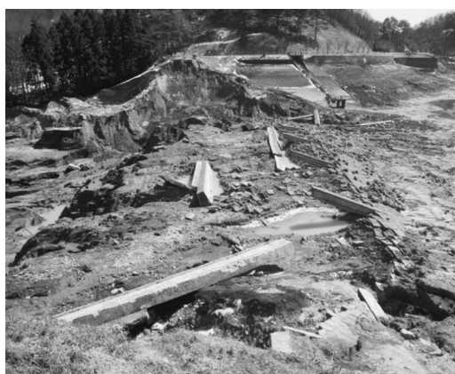
写真-1 本堤決壊後の様子
