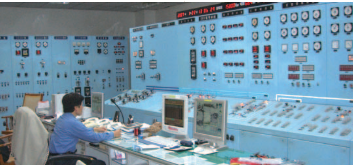
▲ 立霧發電廠的電腦儀控室
